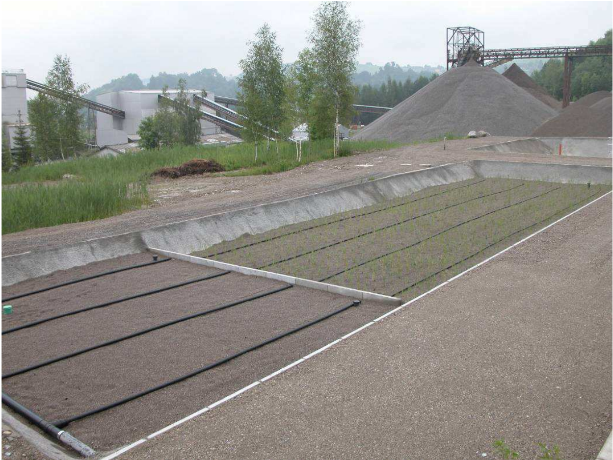
Vorne: Kies-Sand-Filter, Hinten: Schilfbeet zur Behandlung der Oberflächenwässer Sand AG, Schweiz
